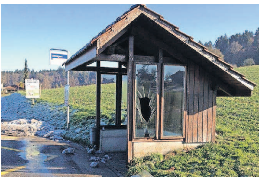
Am Wochenende wurden in Liebigen die Buswartehäuschen zerstört.
